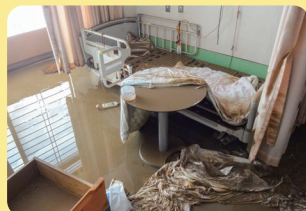
水が引いた後の居室ベッド回り
