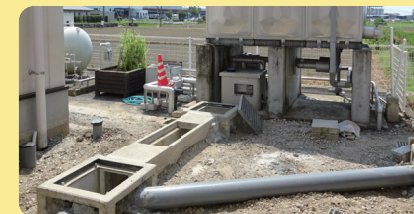
受水槽付近の被害
